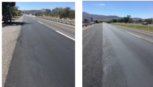
Figura 11. Desplazamiento o deformación y exudación en la ultradelgada
